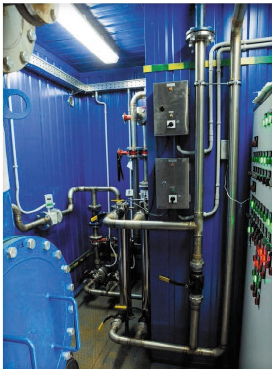
Ультрафиолетовая установка обеззараживания сточных вод
